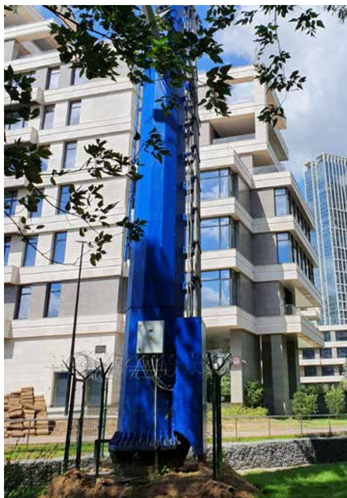
Ограждение переходного пункта и защитный кожух кабеля
