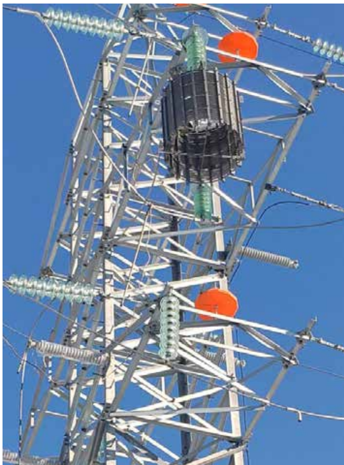
Высокочастотный заградитель, установленный на траверсе
